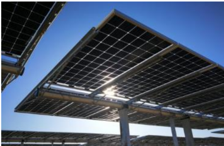
Figura 5.11-2: Vista inferiore tracker dotati di moduli bifacciali
