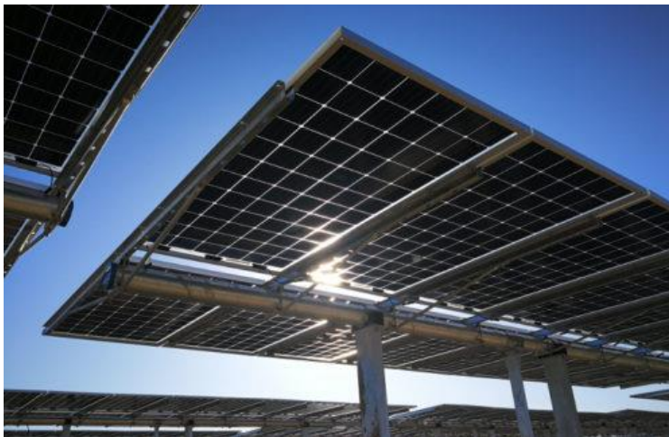
Figura 3.13-2: Vista inferiore tracker dotati di moduli bifacciali
