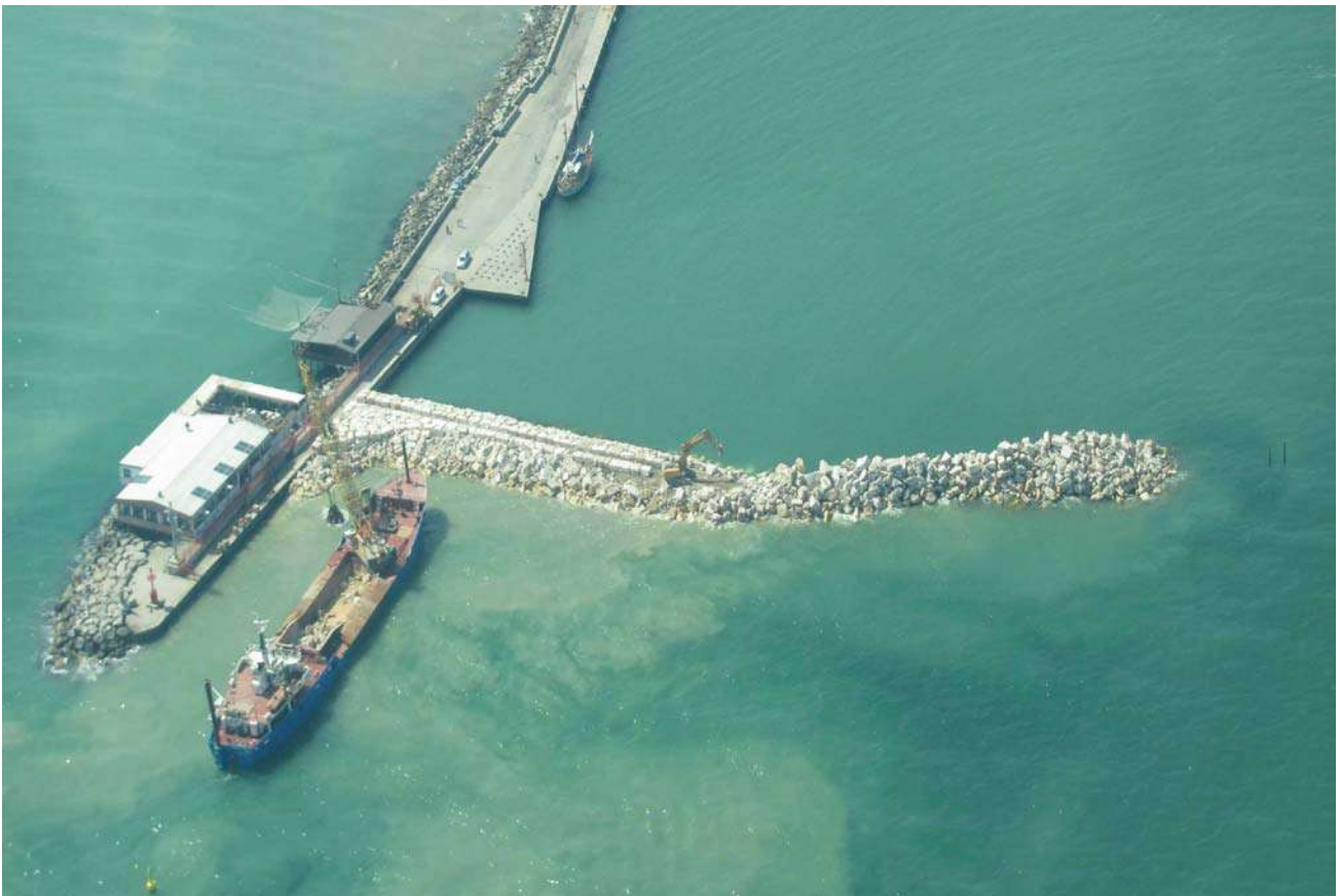
Figura 5 Porto canale di Rimini: fase finale di costruzione della nuova scogliera tramite pontone e gru (Foto aerea 25 marzo 2011)
