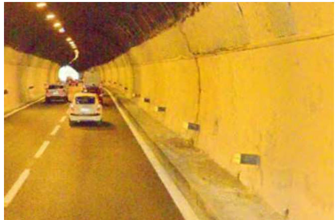
Figura 12 – Centinatura e aloni di umidità in corrispondenza dei piedritti della canna Nord a circa 60 m dall'imbocco lato Roma.
