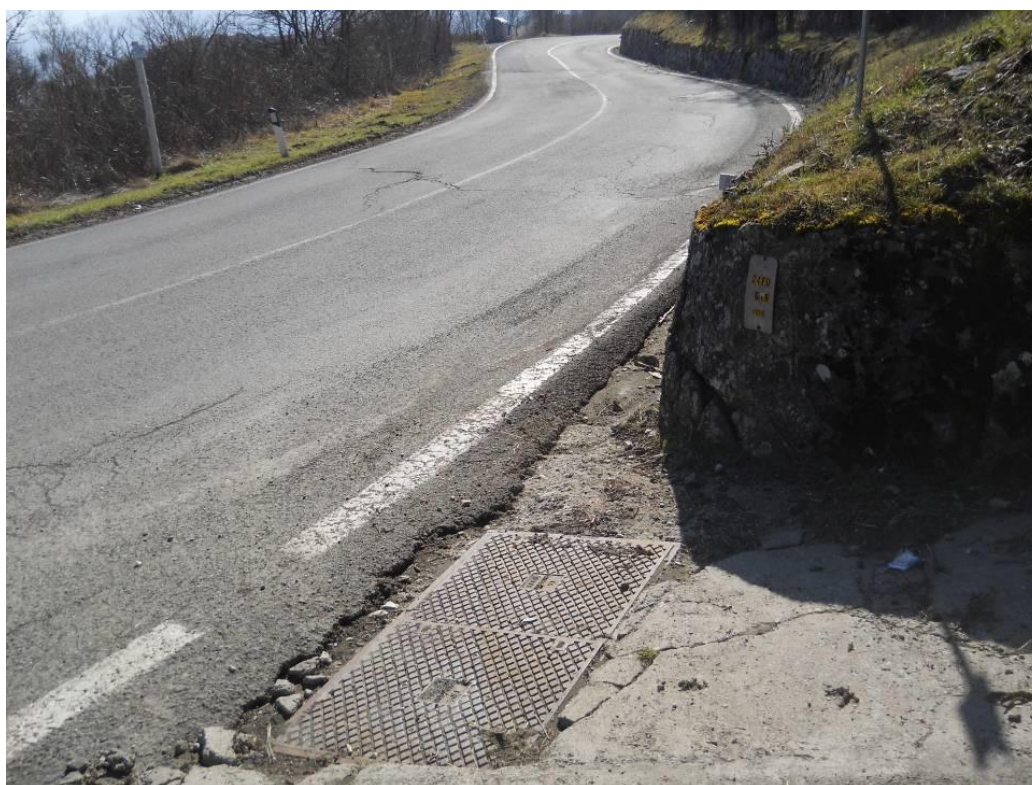
Foto 13 – Nella parte alta della foto ondulazioni del tracciato esistente e nella parte centrale lesioni nel manto stradale (foto dic. 2019)
