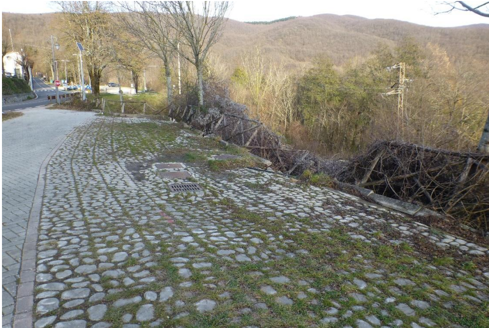
Foto 23 – Cedimento del cordolo con parapetto in legno e del ciglio del parcheggio in località Monte di Fò (Dicembre 2021).
