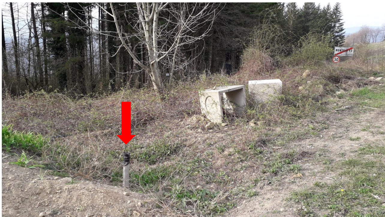
Foto 17 – Inclinometro privato SI2 ubicato appena a monte della curva E.
