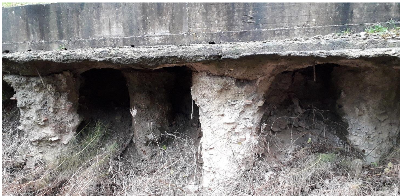
Foto 27d – Frana attiva in località Dogana: particolare dello scalzamento del terreno in corrispondenza delle fondazioni del muro di presidio dell'edificio esistente (Dicembre 2021)
