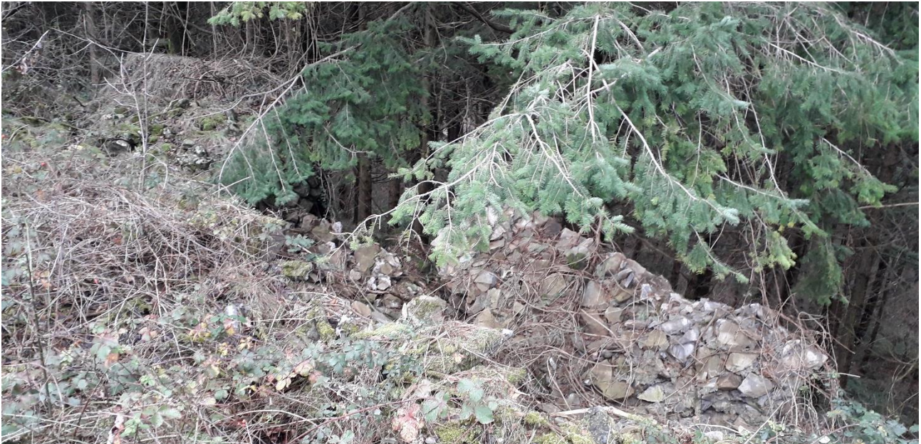
Foto 15 – Collasso di parte del muro di sottoscarpa del vecchio sedime della SR65 (Dicembre 2019).
