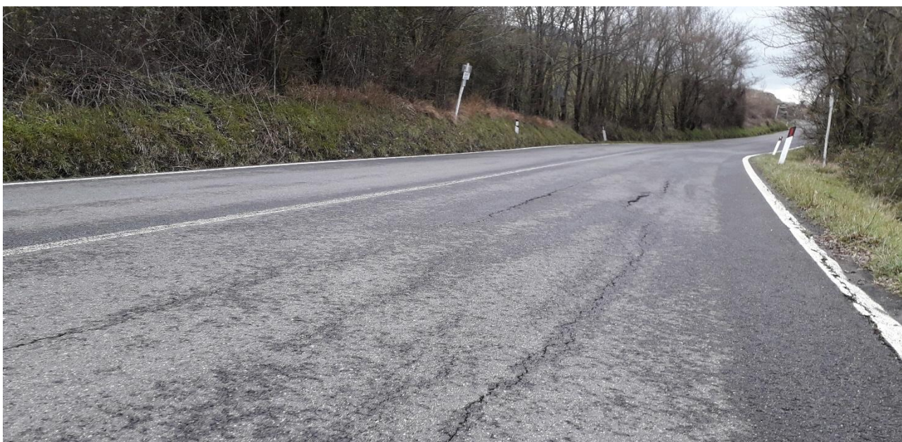
Foto 30 – Deformazione e lesioni stradali all'altezza della curva n° 2 (Dicembre 2019).
