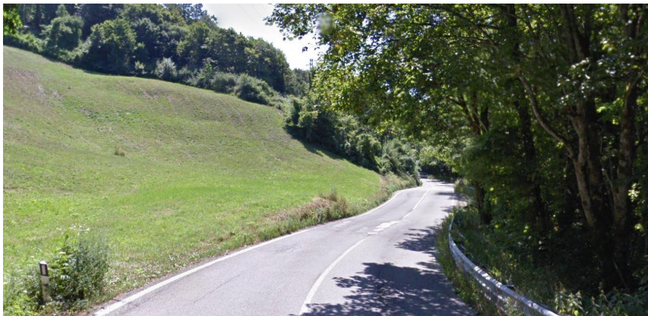
Foto 26 – Tratto di curva A: ondulazioni e lesioni.
