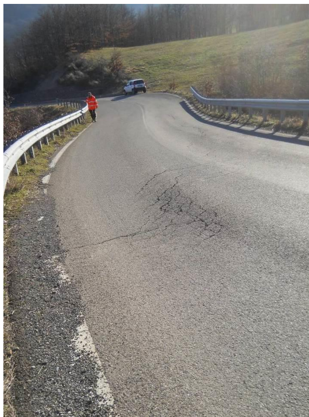
Foto 35 – Settore del sondaggio SD27, lesioni nel manto stradale (Dicembre 2019).
