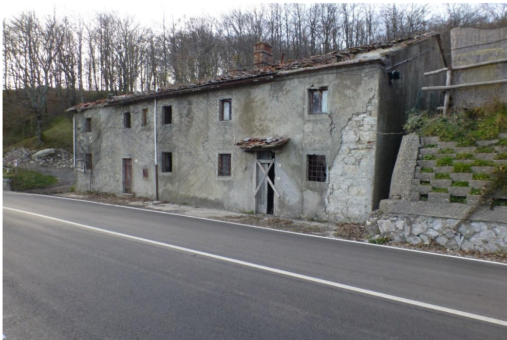
Foto 24 – Lesioni vecchio edificio in località Monte di Fò (Dicembre 2021).
