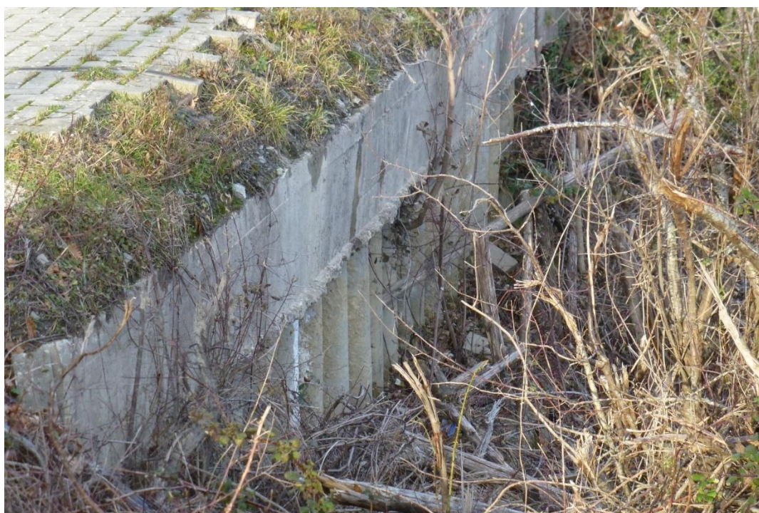
Foto 22 – Cedimento del ciglio del parcheggio in località Monte di Fò a valle della strada S.R.65 (particolare della palificata inferiore, Dicembre 2021)
