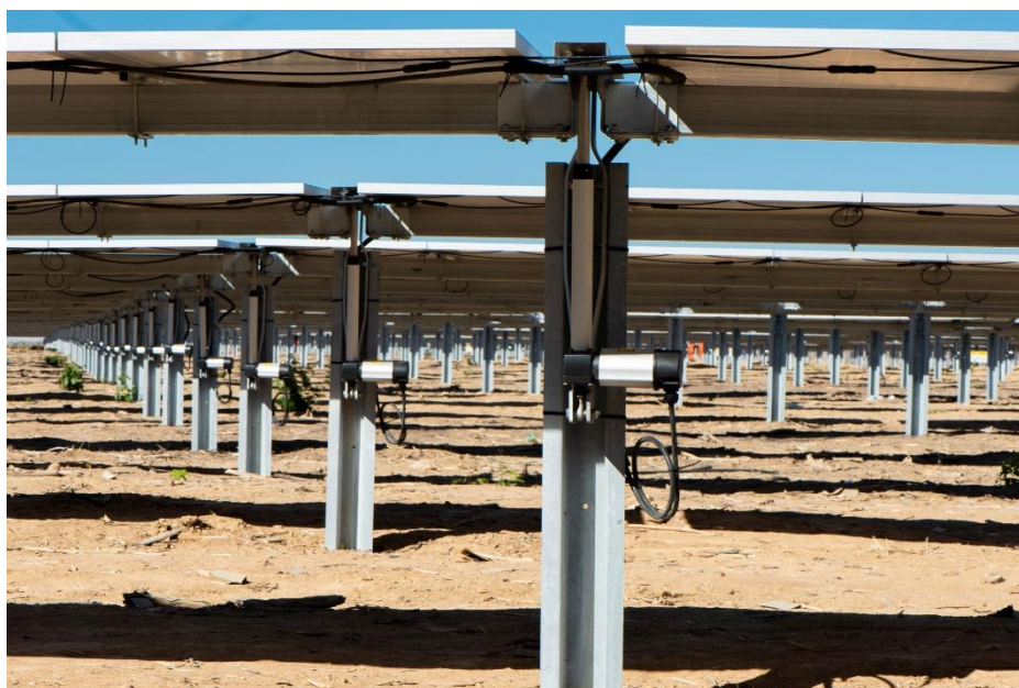
Fig. 5 - Palo del tracker infisso nel terreno
