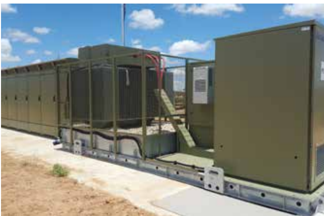
AUSTRALIA Barcaldine, 20 MW HEC PLUS + MV SKID
