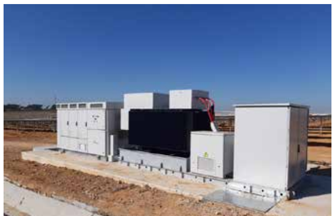
SPAIN Los Limonetes, 46 MW HEMK + MV SKID
