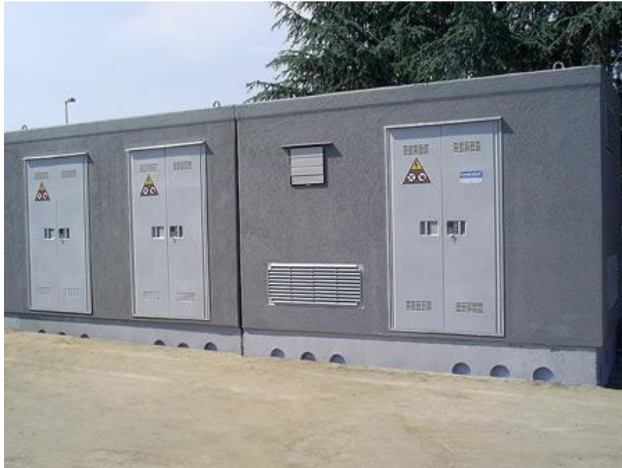
Figura 27: Esempio di cabina di parallelo e control room
