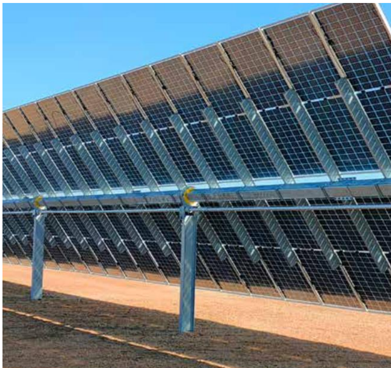
Figura 23: Particolare inseguitori monoassiali
