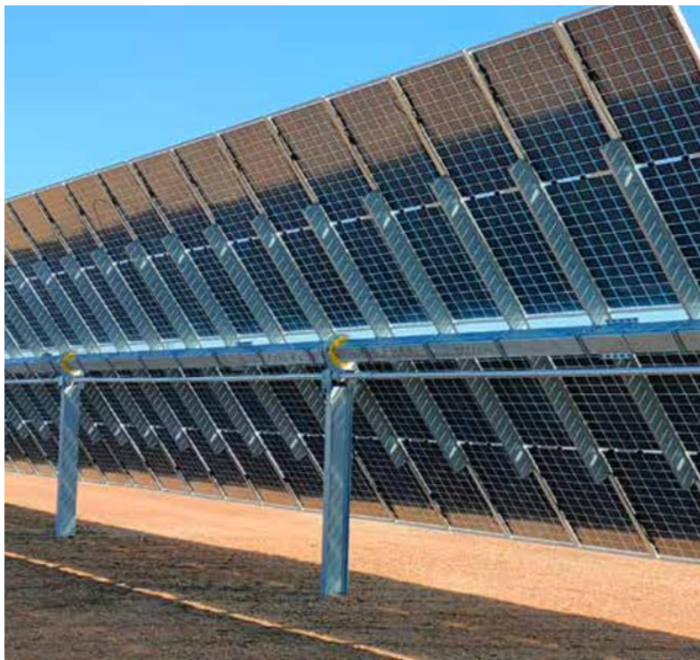
Figura 4.4: Particolare inseguitori monoassiali
