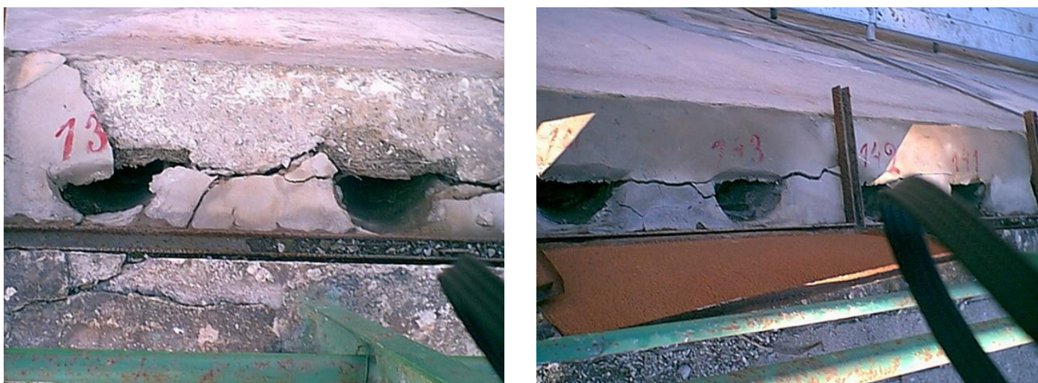
Figura 3-7: lesioni passanti che di fatto nel tempo hanno determinato il distacco strutturale tra le lastre del manto di tenuta e il sottostante sistema di canne drenanti murate sul paramento esterno del muro di contenimento di monte della diga in rockfill.
