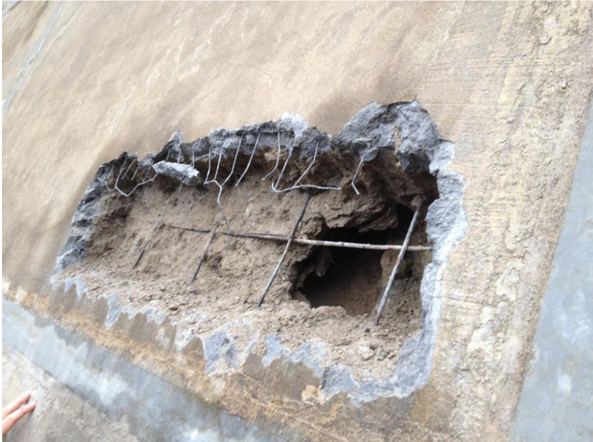
Figura 3-4: saggio esplorativo effettuato su una lastra del manto di tenuta. Si distingue uno spessore di rinforzo più recente (strato scuro di malta speciale rinforzato con rete metallica diffusa di piccolo diametro e il sottostante spessore della lastra originaria con interposta armatura in rete elettrosaldata \Phi 6, maglia 20x20 cm. Nella parte destra si nota la cavità di una canna drenante.
