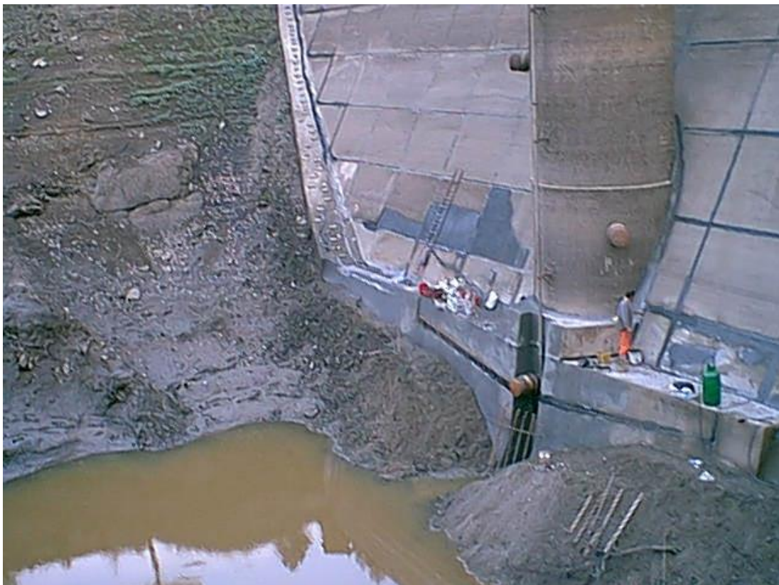
Figura 3-1: manto di tenuta di monte in lastre prefabbricate in c.a., durante l'intervento di manutenzione straordinaria dell'ottobre 2000.
