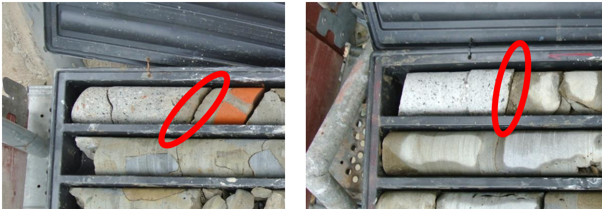
Figura 3-6: carotaggi del manto di tenuta e del retrostante paramento murario. All'interno del contorno rosso si evidenzia la linea di frattura presente nelle connessioni tra le lastre e la sottostante muratura.
