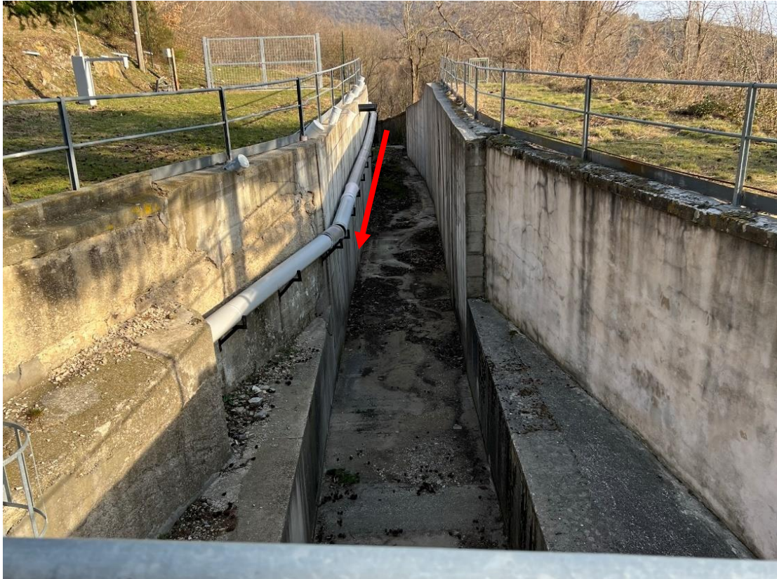
Figura 5-15: documentazione fotografica del tratto intermedio della canalizzazione che convoglia all'interno dell'invaso i deflussi generati dal cosiddetto "bacino imbrifero allacciato".
