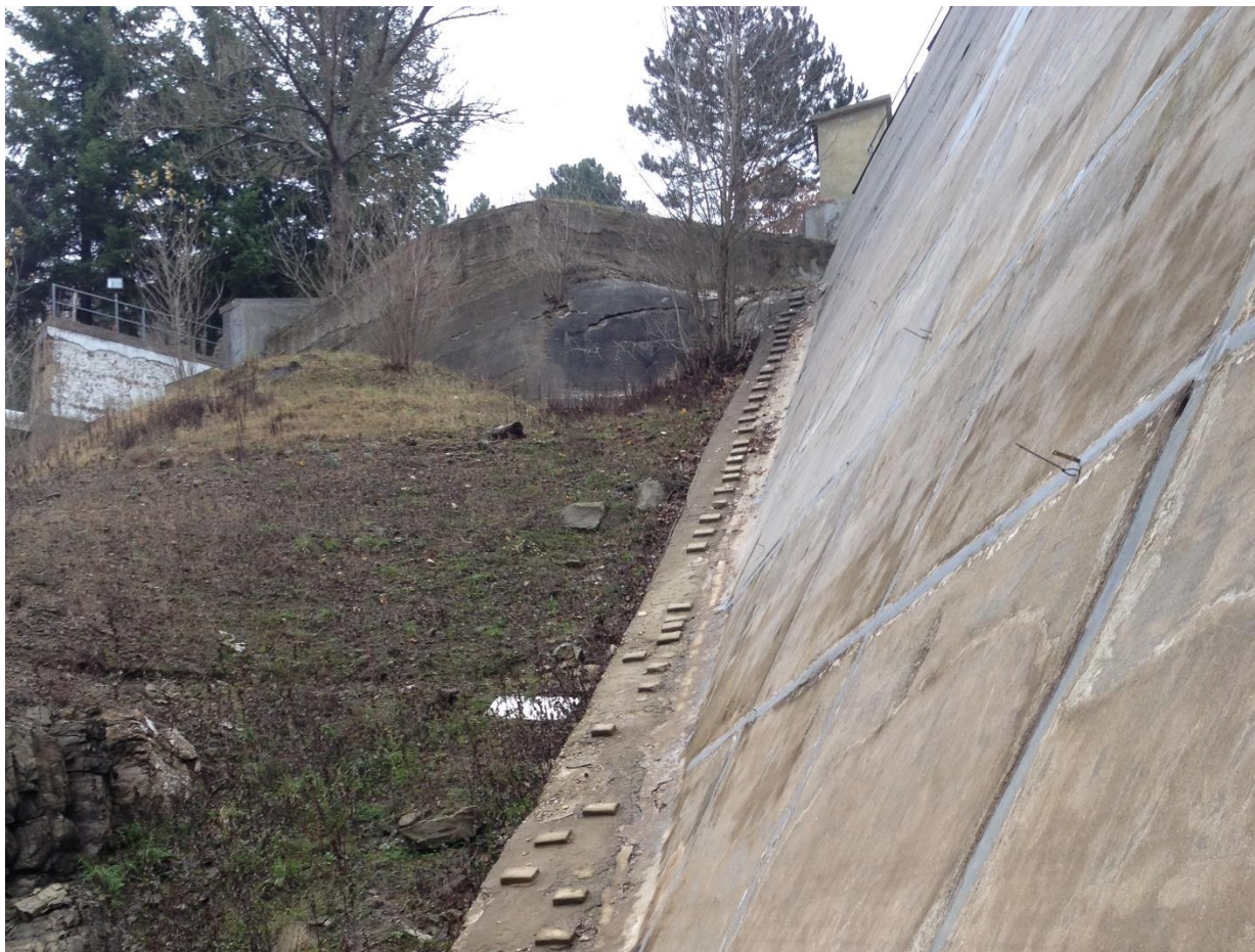
Figura 6-1 Stato attuale della spalla in sinistra idrografica
