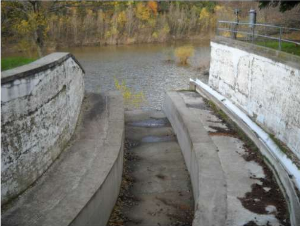
Figura 10 Vista dell'imbocco del canale fuggatore dello scarico di superficie a soglia libera.
