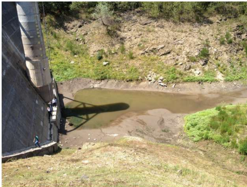
Figura 14 Vista a serbatoio vuoto sulla parte emergente dal terreno (al piede del manto di tenuta del paramento di monte) del blocco di fondazione al cui interno si sviluppa il cunicolo d'ispezione dei drenaggi
