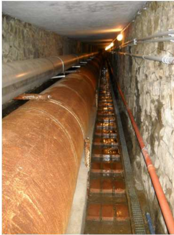
Figura 8 Cunicolo d'ispezione dello scarico di fondo e della condotta di derivazione
