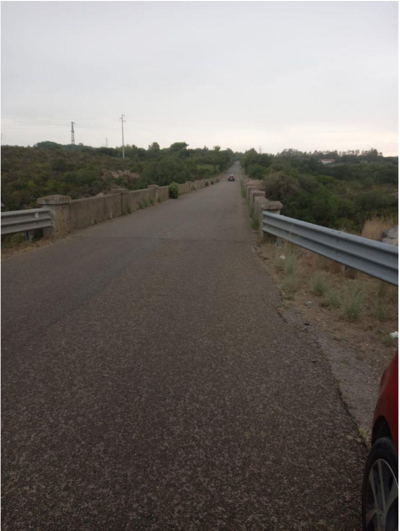
Ponte Su Sturruliu, luogo di attraversamento dei cavidotti. Ponte trascurato e mai collaudato. L'attraversamento obbliga le auto a fermarsi in caso di presenza di mezzi pesanti.
