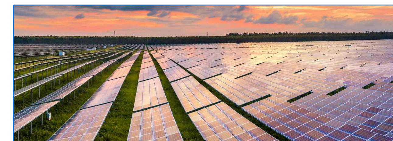
Impianto Di Produzione Di Energia da Fonte Solare Fotovoltaica Denominato "New Sun 1"
