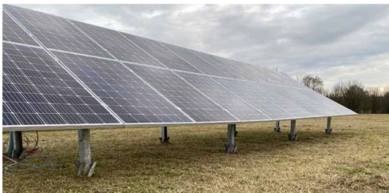
Figura 3.4 – Assetto dei pannelli fotovoltaici
