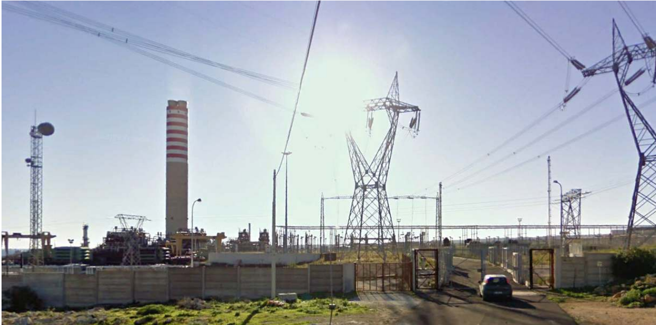
Figura 16 - Stazione TERNA prevista per la connessione alla rete elettrica ubicata in località di Priolo Gargallo (SR)
