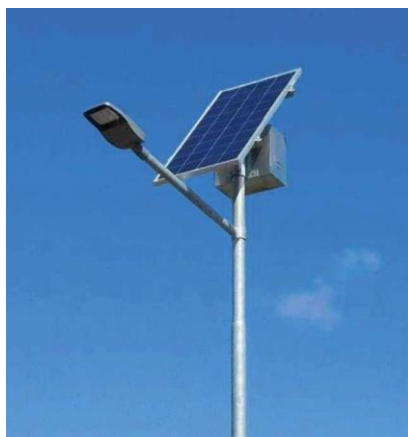
Figura 6-25 - Lampione fotovoltaico autosufficiente
