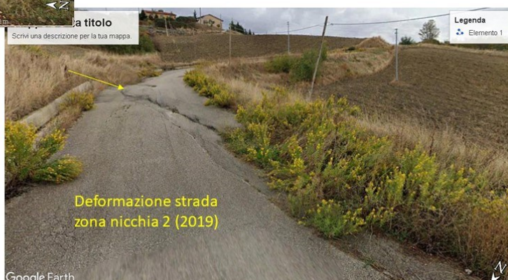
Figura 5-28 - Deformazioni nel manto stradale nella zona di nicchia n. 2 di Figura 5-27.
