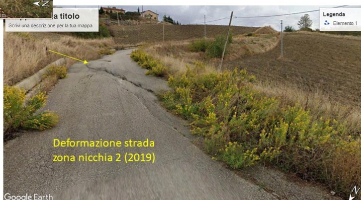
Figura 2-28 - Deformazioni nel manto stradale nella zona di nicchia n. 2 di Figura 2-27.
