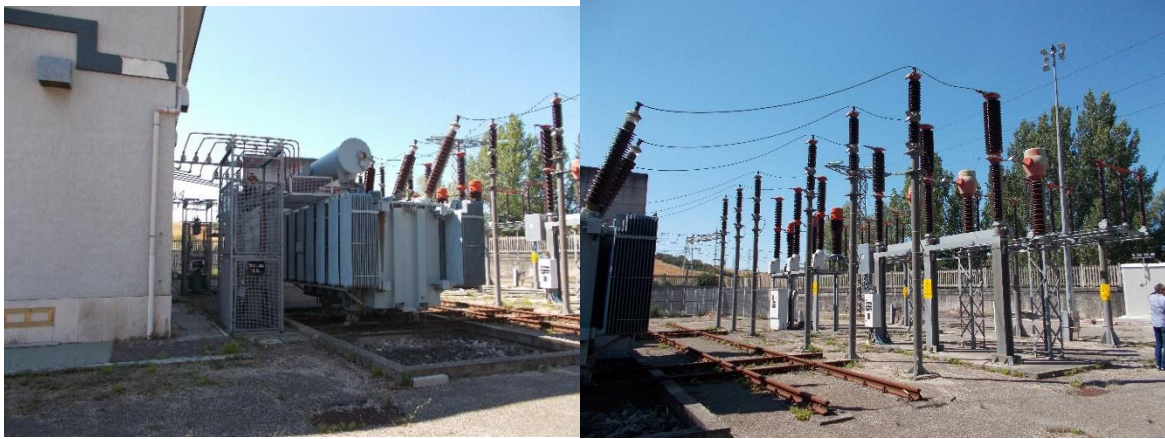
Trasformatore e piazzale apparecchiature AT
