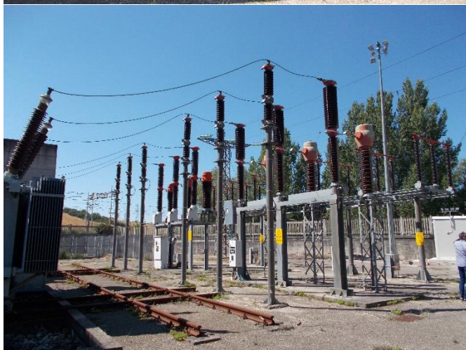
Figura 6. Trasformatore di Gruppo B
