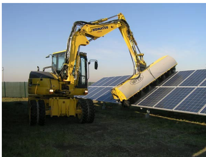
Figura 22 - Lavaggio moduli fotovoltaici
