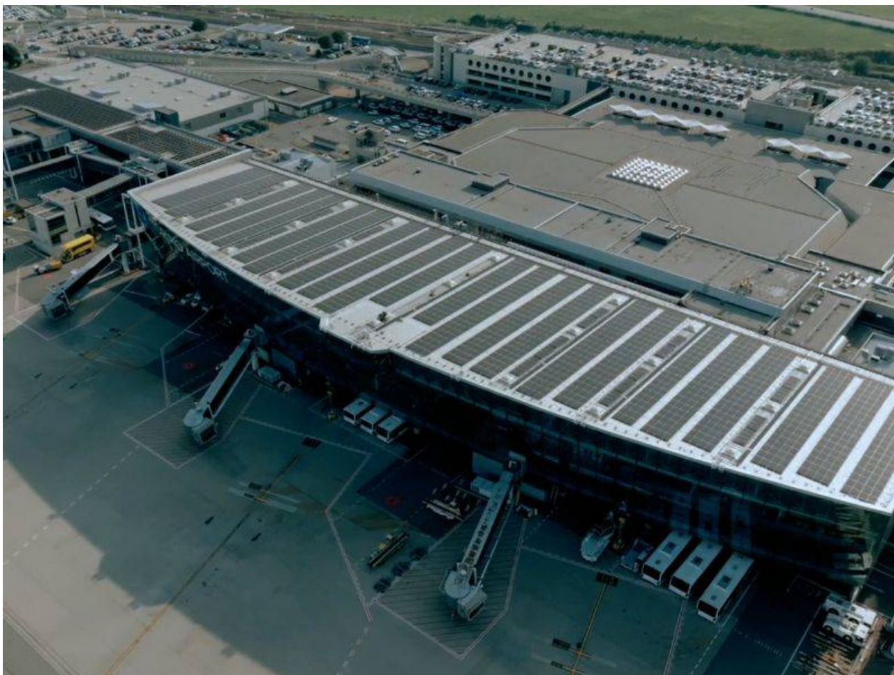
Figura 6.3 - Fotovoltaico su tetto - Aeroporto di Torino.
