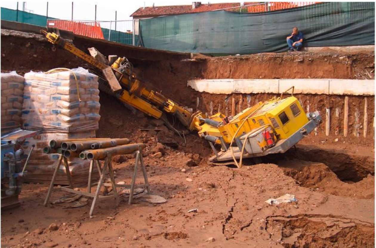
Figura 25 – OP nei depositi alluvionali; si nota molto bene la presenza di cavità di dimensioni diverse a breve distanza, come si vedrà nelle immagini seguenti, si intuiscono zone di interconnessione tra le cavità vere e proprie. (fonte: dott. Fabio Baio)
