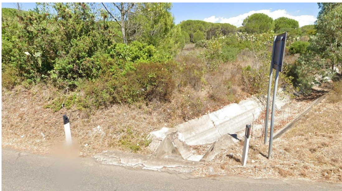
Figura 6.33: Immagine dell'interferenza della connessione con l'elemento idrico Fiume 20991, vista verso monte.
