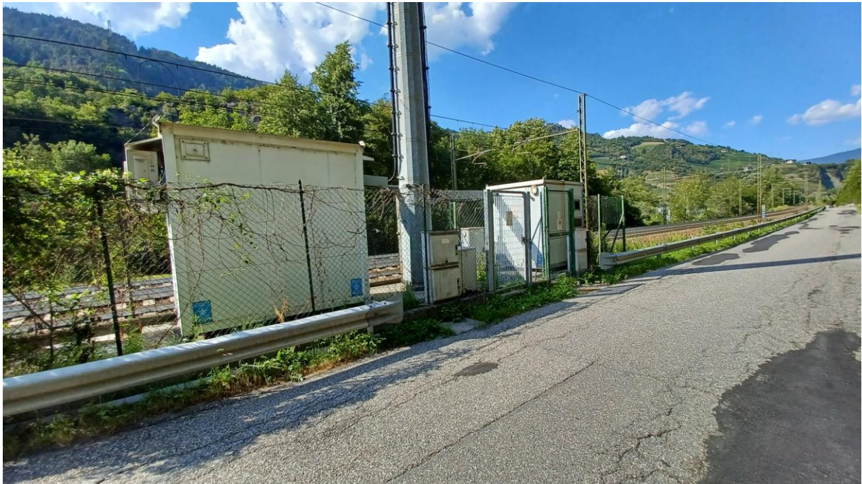
Figure 5-11 – Documentazione fotografica a comprova della presenza di manufatti e opere d'arte nell'intorno della viabilità esistente (nello specifico: sul ciglio di valle i presidi ferroviari a ridosso della barriera di sicurezza stradale esistente e lo stretto affiancamento alla linea)
