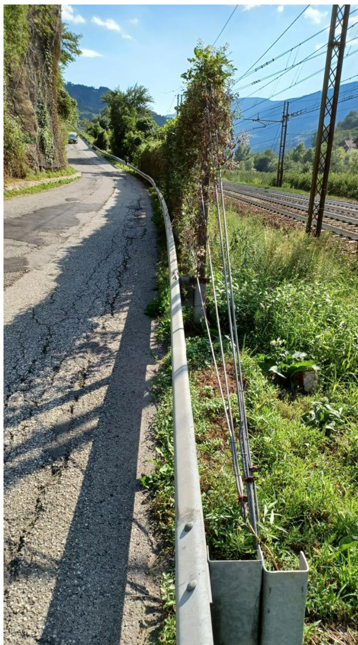
Figure 5-9 – Documentazione fotografica a comprova della presenza di manufatti e opere d’arte nell’intorno della viabilità esistente (nello specifico: sul ciglio di monte si notano gli interventi corticali sul versante roccioso; sul ciglio di valle una barriera paramassi (ricoperta dalla vegetazione) a ridosso della barriera di sicurezza stradale esistente, a cui è parzialmente tirantata
