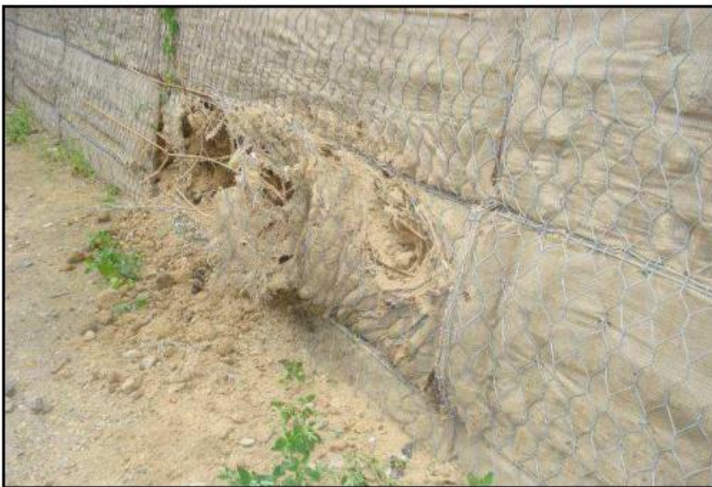
Figure 10-2 - Svuotamento del riempimento vegetale dovuto ad un urto sul paramento
