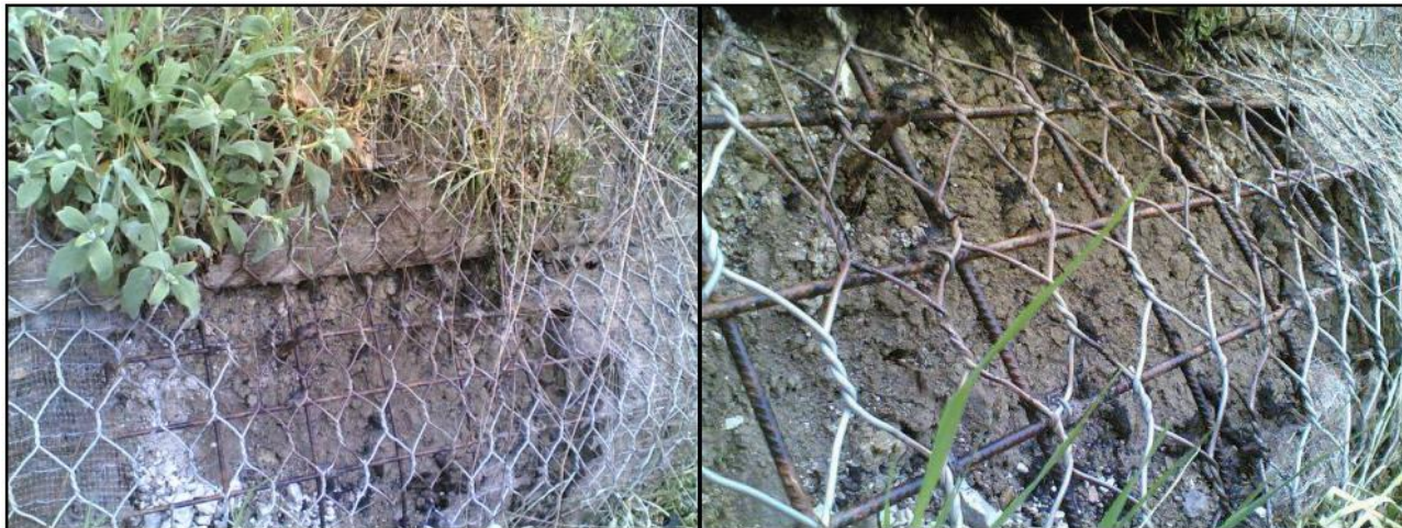
Figure 10-3 - Perdita di materiale fine a causa di incendio e conseguente danneggiamento del ritentore di fine. Il terreno vegetale dietro al paramento rimane esposto.
