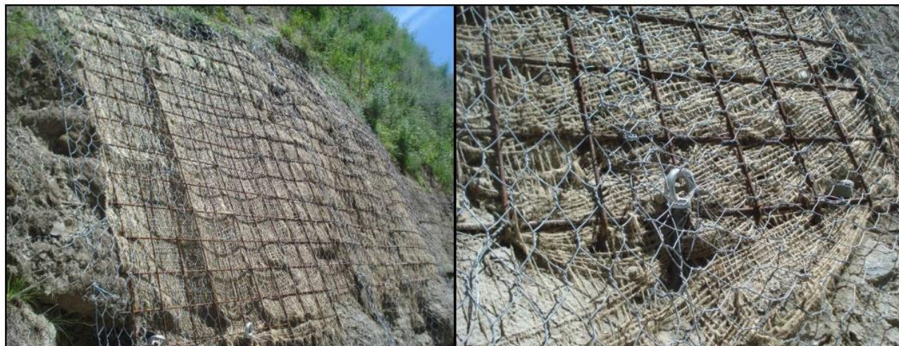
Figure 10-4 - Interventi di manutenzione dopo danni dovuti ad impatto
