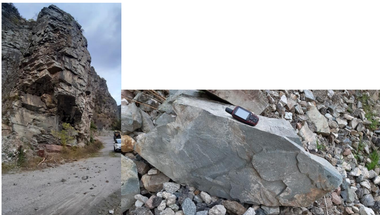
Fig. 54: Detrito e blocchi caduti recentemente alla base della scarpata in dioriti nei pressi dell'imbocco Sud della Galleria Scaleres (punto localizzato circa 150 m a Ovest del tracciato del binario pari).
