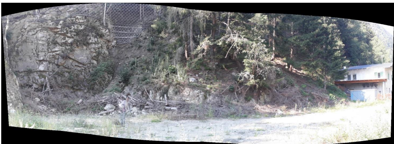
Fig. 51: Panorama della parte bassa del versante in cui è visibile la prima barriera paramassi esistente.
