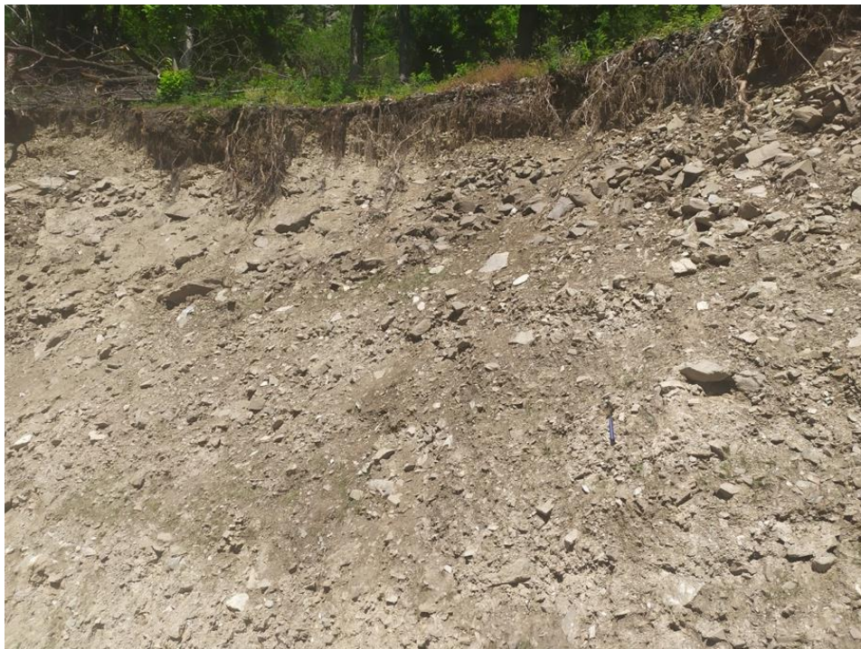
Fig. 39: Vista del deposito di frana lungo uno sbancamento antropico.
