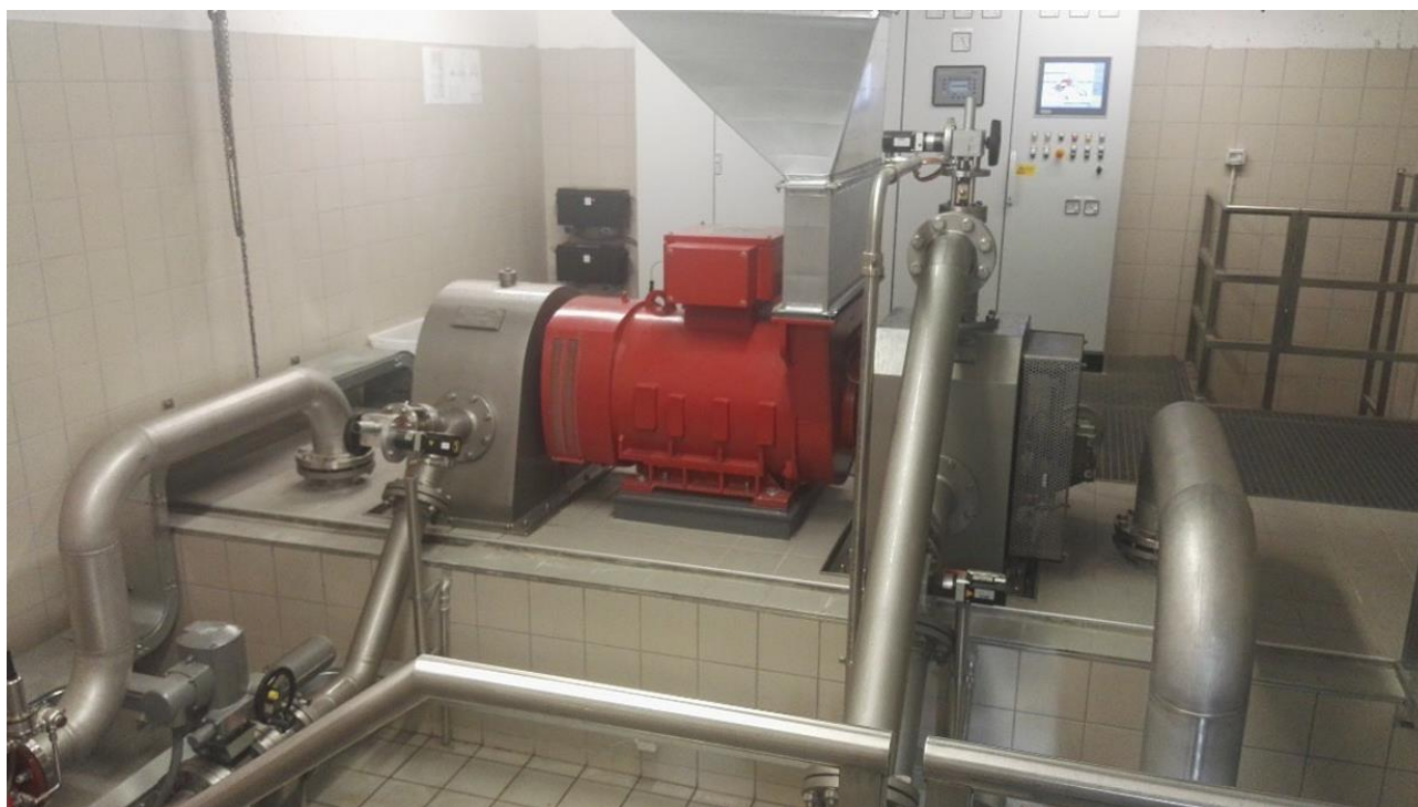
Figura 35: Centrale acquedottistica ove vengono convogliate le acque della sorgente B_000761 e B_000742/5.
