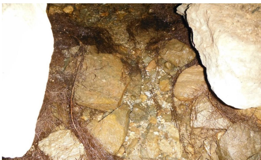
Figura 41: Particolare del tunnel di adduzione della sorgente B_000789 Stollenquelle-Griesserhof.
