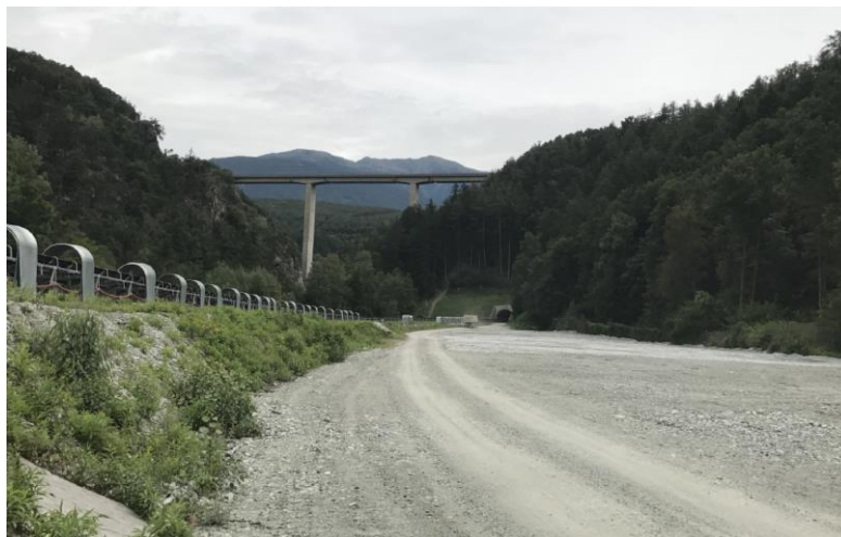
Figura 17-8 Ripiano di base adiacente al fiume Isarco attualmente sede del cantiere BBT
