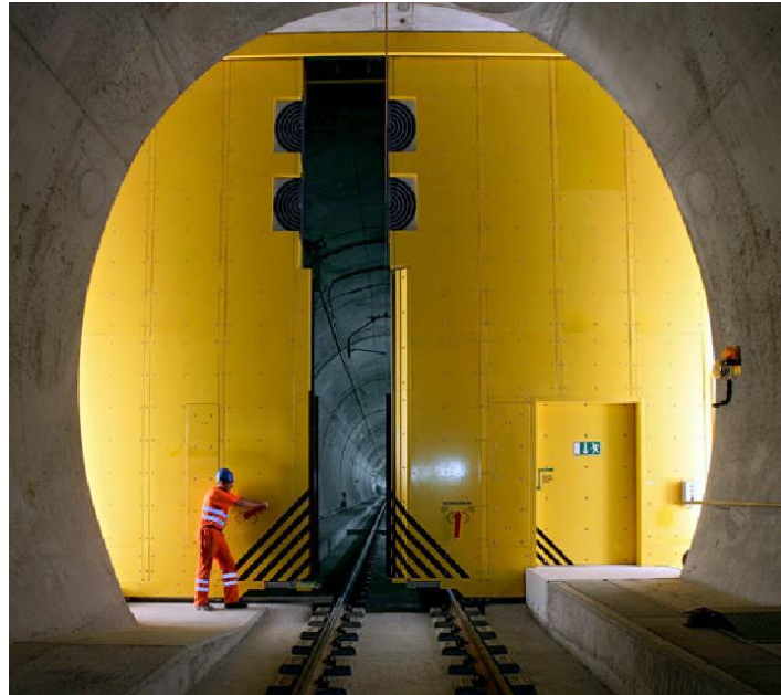
Figura 47 - Porte scorrevoli disconnessione fumi (Galleria Lötschberg)
