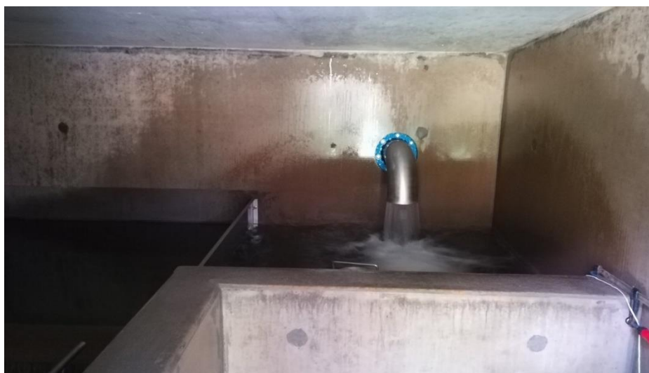
Figura 15: Opera di captazione della sorgente Kemperbrunn Obere
