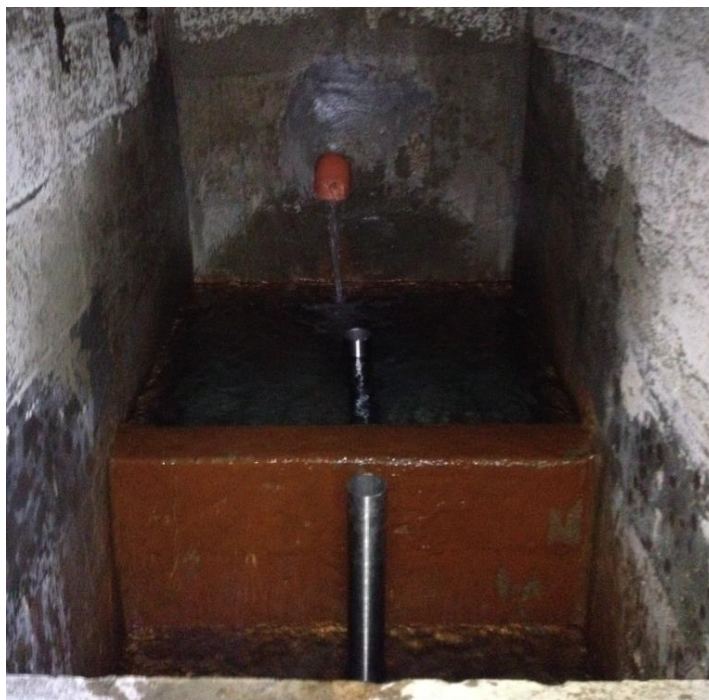
Figura 18: Opera di presa della sorgente Tauberbrunn Untere (B_001128)
