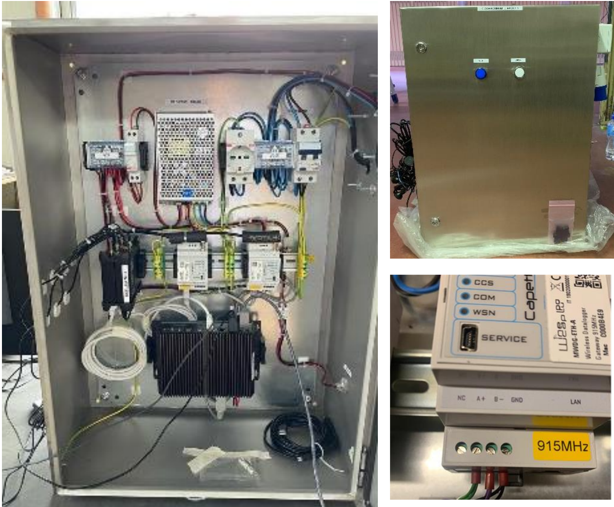
Figura 7 - Interno quadro, cruscotto e gateway con frequenza 915 Mhz
