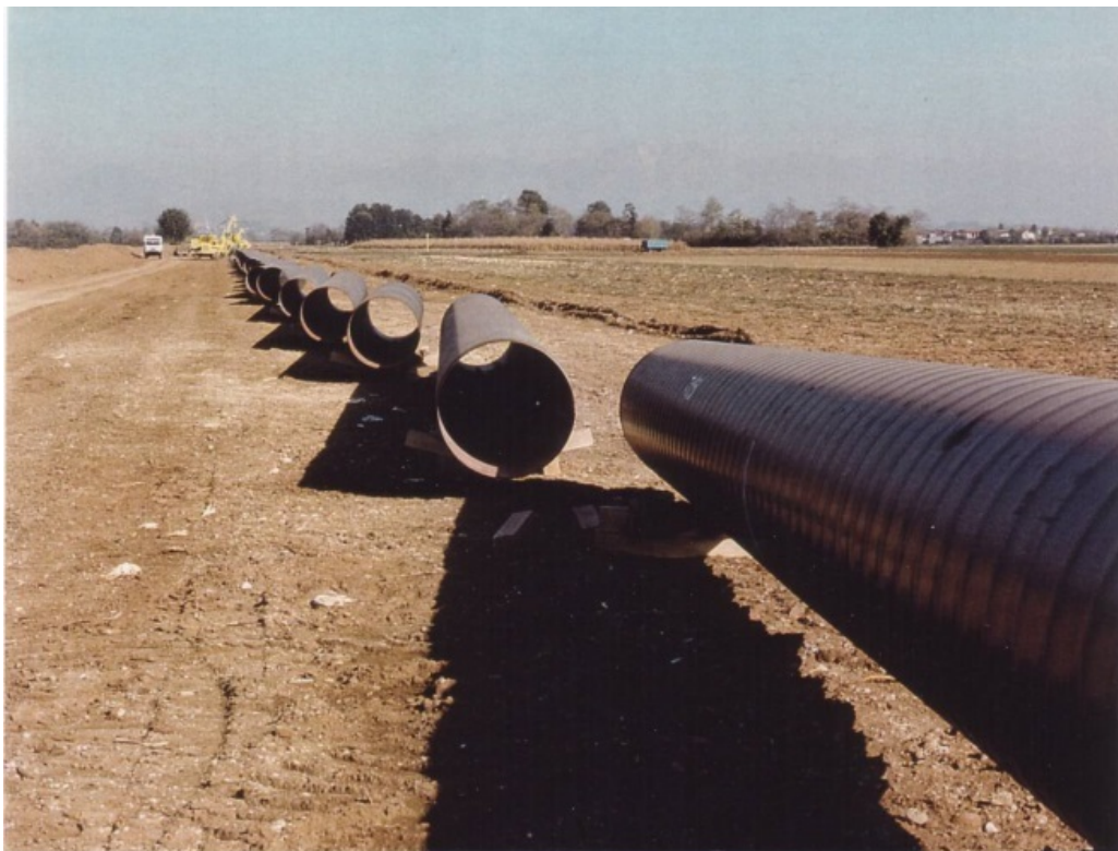
Foto 2.D: Esempio di sfilamento tubazioni
