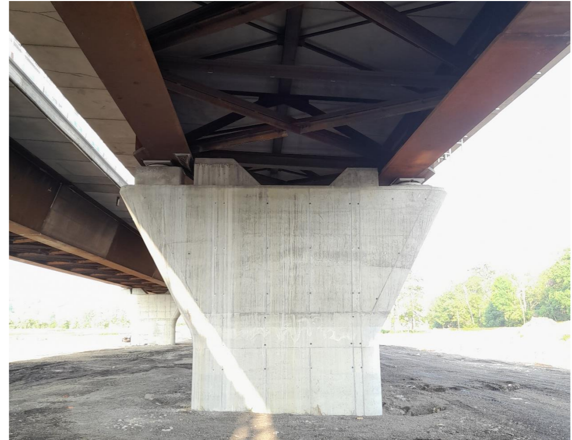
FIGURA 2-5 PARTICOLARE IMPALCATO A TRAVI INCLINATE E CONFORMAZIONE DELLA PILA (VISTA FRONTALE), DEGLI APPOGGI E DEI RITEGNI SISMICI
