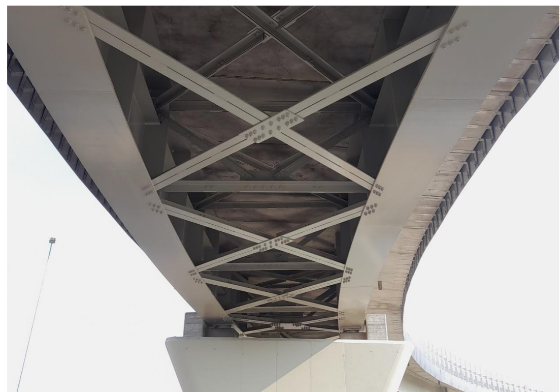
FIGURA 2-14 RAMPA DI USCITA ASTI-ALBA OVEST – VISTA DI DETTAGLIO DELLA STRUTTURA A TRAVI VERTICALI DELL'IMPALCATO
