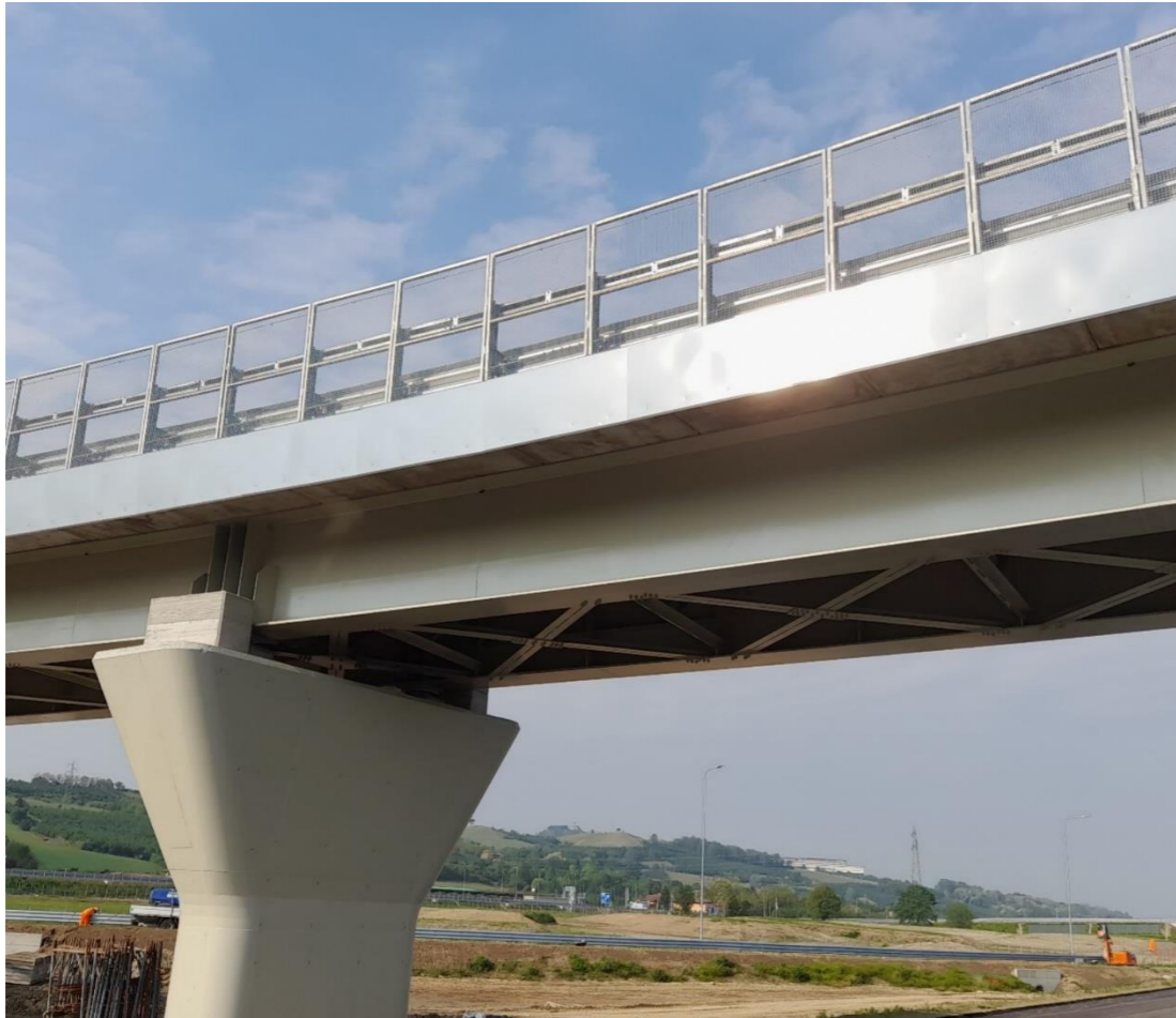
FIGURA 2-20 RAMPA DI USCITA ASTI-ALBA OVEST – VISTA DELLA RETE ANTISCAVALCO E DELLE VELETTE DI MASCHERAMENTO
