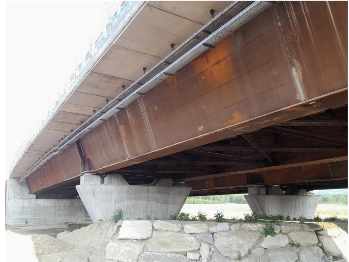
FIGURA 2-22 SISTEMA DI APPENSIONE DEI CAVIDOTTI ALL'INTRADOSSO DELLA SOLETTA. SI NOTI LA PREDISPOSIZIONE DELL'AGGANCIO DELLE VELETTE, IN CORSO DI INSTALLAZIONE
