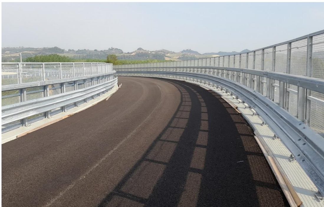
FIGURA 2-21 RAMPA DI INGRESSO ALBA OVEST-CUNEO – SICURVIA BORDO PONTE, INTEGRATO CON RETE ANTISCAVALCO
