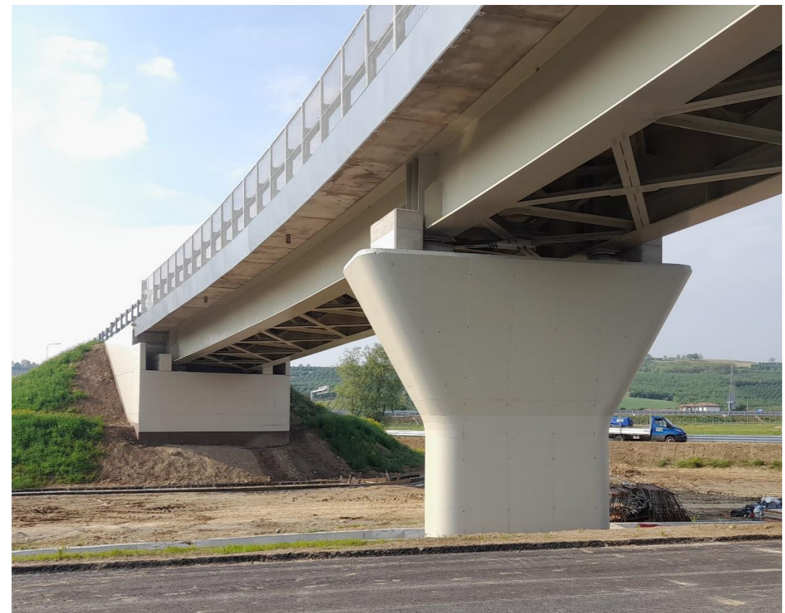
FIGURA 2-12 RAMPA DI USCITA ASTI-ALBA OVEST – VISTA DELLA CAMPATA TERMINALE DI COLLEGAMENTO PILA-SPALLA. SI NOTI L'AMMORSAMENTO PARZIALE DELLA SPALLA NEL CORPO DEL RILEVATO DI APPROCCIO
