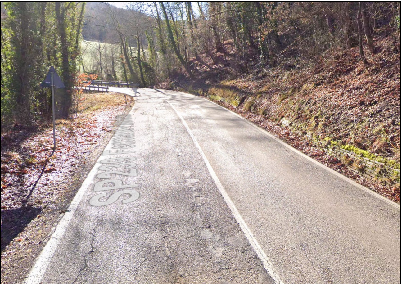
Fig. 3 – Tratto in prossimità del ponte di San Ruffino con degrado della pavimentazione e banchine inesistenti
