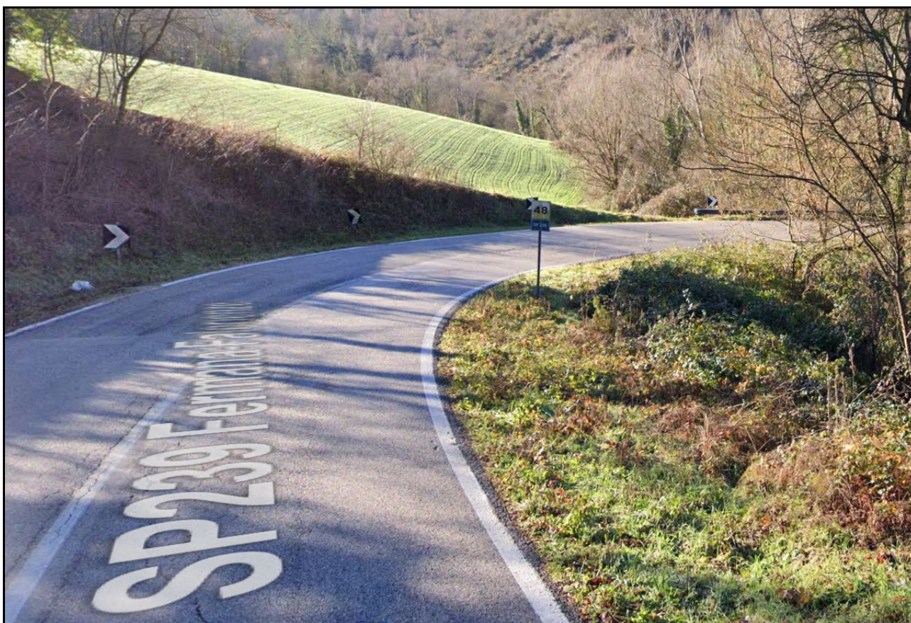
Fig. 5 – Assenza di dispositivi di ritenuta stradale a protezione del rilevato
