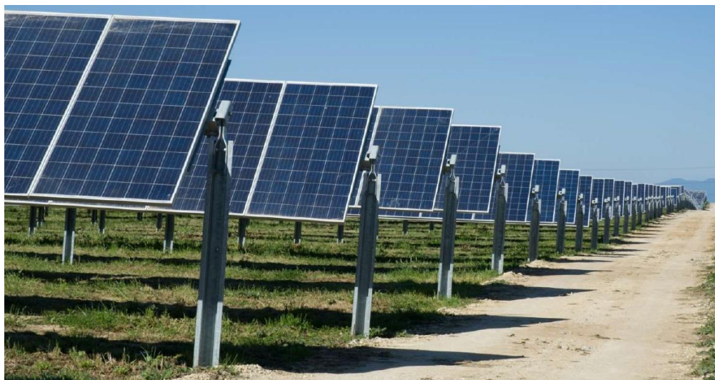
Figura 2 - immagine esemplificativa di inseguitori mono-assiali Convert 1P - configurazione 1P (fonte: Convert Valmont Solare)
