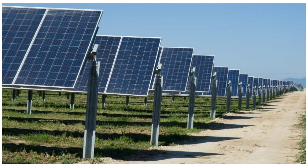
Figura 8 - immagine esemplificativa di inseguitori mono-assiali Convert 1P - configurazione 1P (fonte: Convert Valmont Solare)
