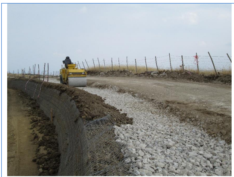
Figura 8.3 – Esempio di opera in terre rinforzate - Fonte HE
