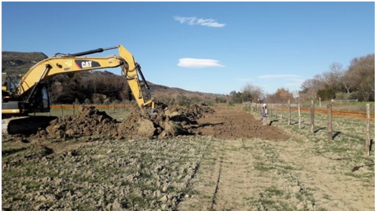
Fig. 2.8/A: Apertura pista di lavoro con accantonamento (a sinistra) dello strato superficiale di terreno (humus)
