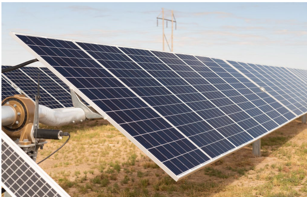
Figura 17 Esempio di tracker monoassiale monofila montante moduli bifacciali: si scorge in rosso il motore per l'inseguimento Solare
