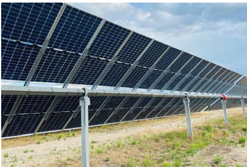
Figura 18 - Esempio di tracker monoassiale montante moduli bifacciali: in rosso si evidenzia il motore per l'inseguimento Solare
