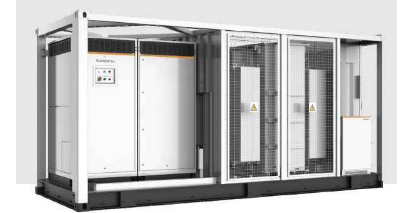
Dettaglio Power Conversion System
