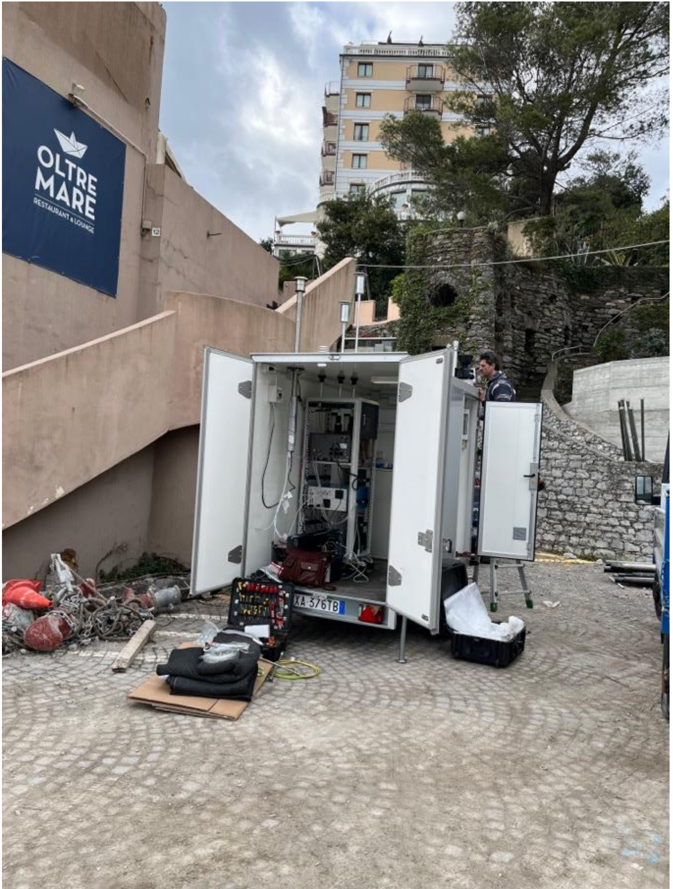
Centralina operativa dal 01/02/2023 (foto del 01/02/2023)
