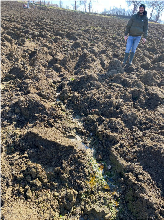
Figura 38 venute d'acqua lungo la pozione di valle del versante
