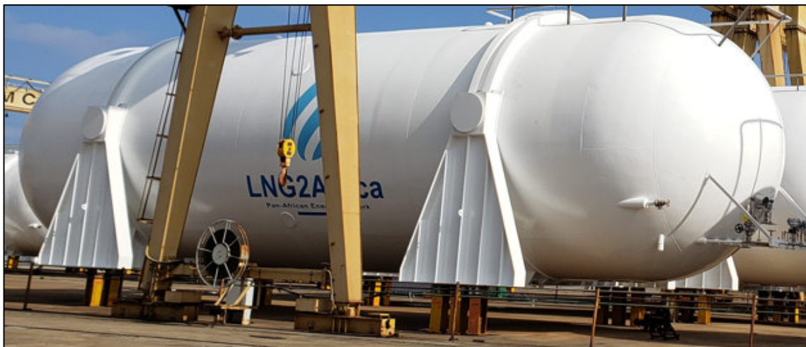
Figura 6 - foto serbatoio criogenico stoccaggio LNG
