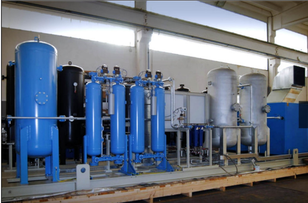
Figura 8 - esempio installazione skid produzione azoto e aria strumenti
