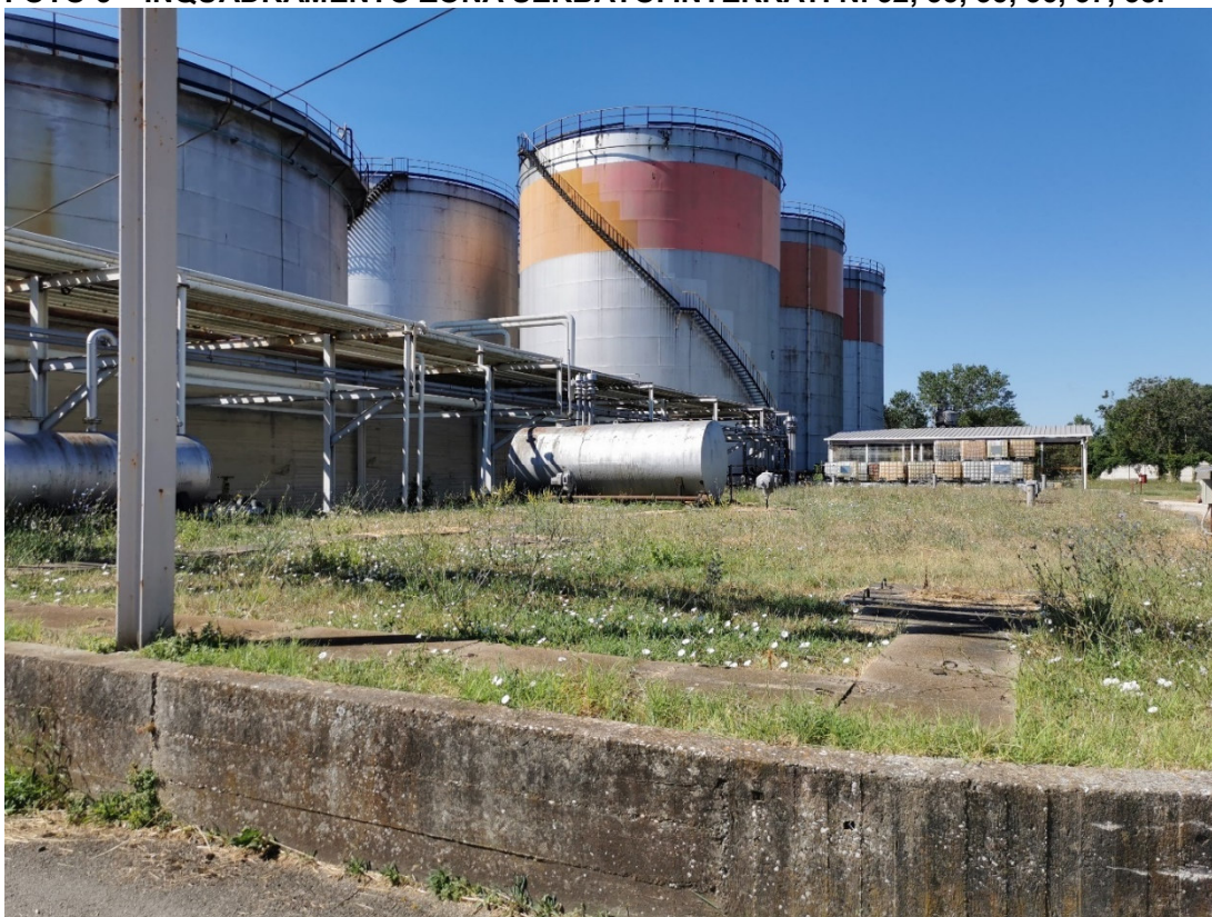
FOTO 5 – INQUADRAMENTO ZONA SERBATOI INTERRATI N. 32, 33, 35, 36, 37, 38.
