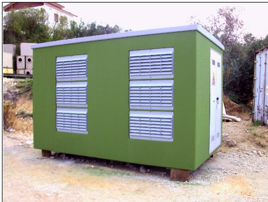
Tipico cabina elettrica prefabbricata
